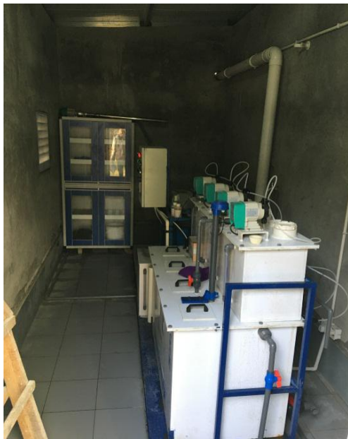
污水预处理系统
