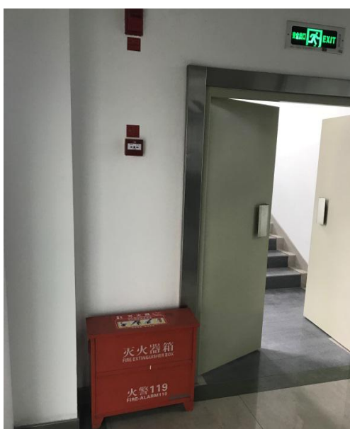
火警报警器和消防通道
