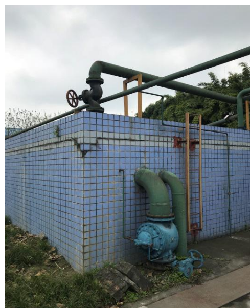
园区井水蓄水池
